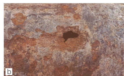
Figura 4: Corrosão eletrolítica em tubos de aço-carbono provocada por corrente de fuga: (a) em parte de um equipamento; (b) em uma tubulação industrial.
