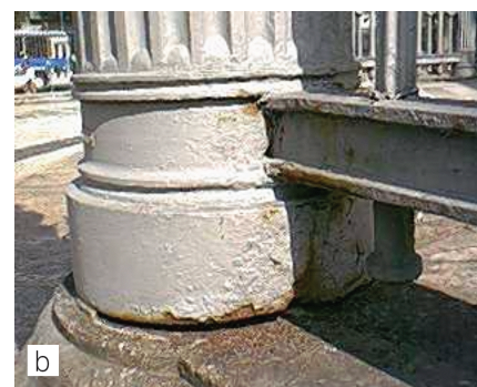
Figura 2: Corrosão eletroquímica, decorrente da exposição atmosférica, no gradil em monumento de ferro fundido situado na Praça Tiradentes (Centro do Rio de Janeiro): (a) vista da coluna do gradil; (b) detalhe ampliado da base da coluna.
